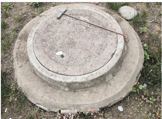
园区废水总排口
