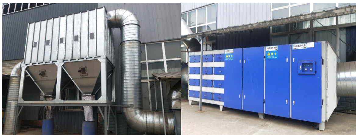
图 3-1 废气处理设施
