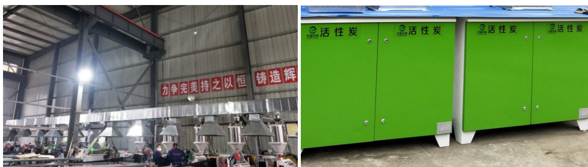
图 3-1 废气处理设施
