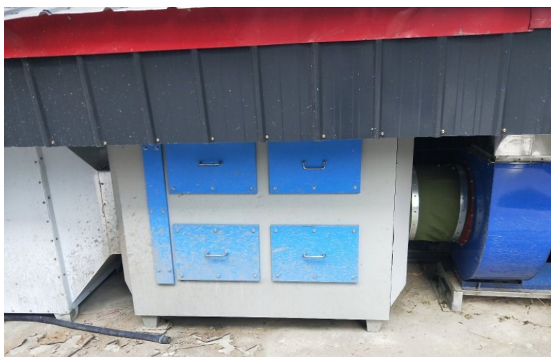
图 3-2 废气处理设施
