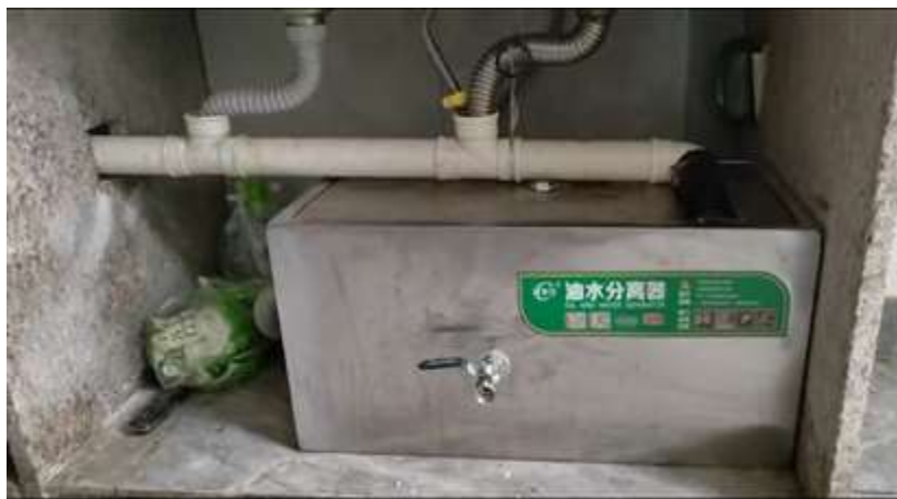
图 3-1 废水处理设施
