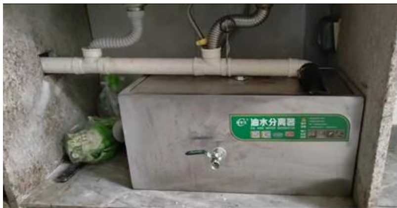
图 3-1 废水处理设施
