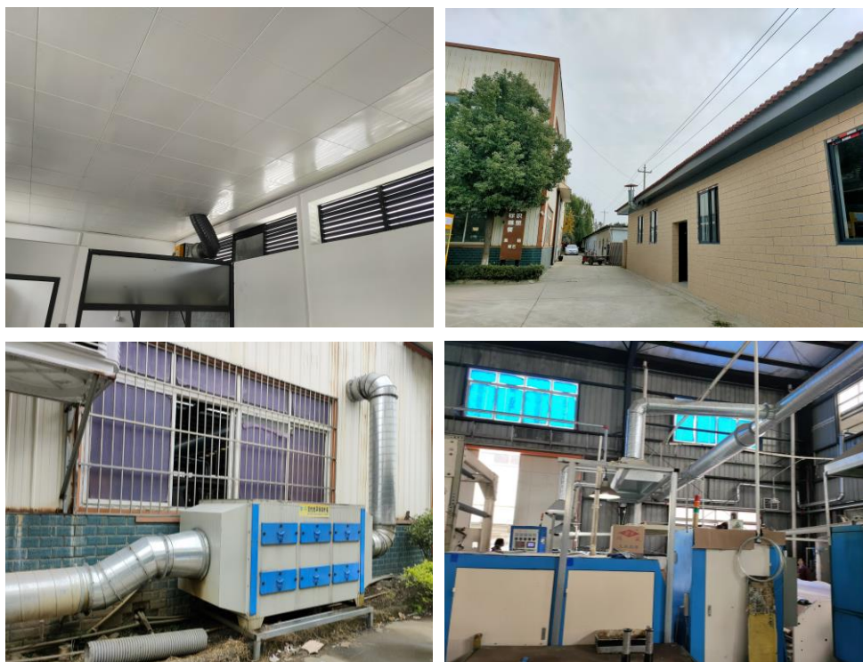
图 3-2 废气处理设施
