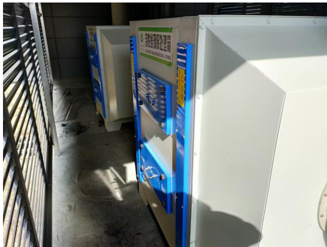
图 3-1 废气处理设施
